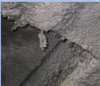
Rivestimenti in amianto spruzzato
